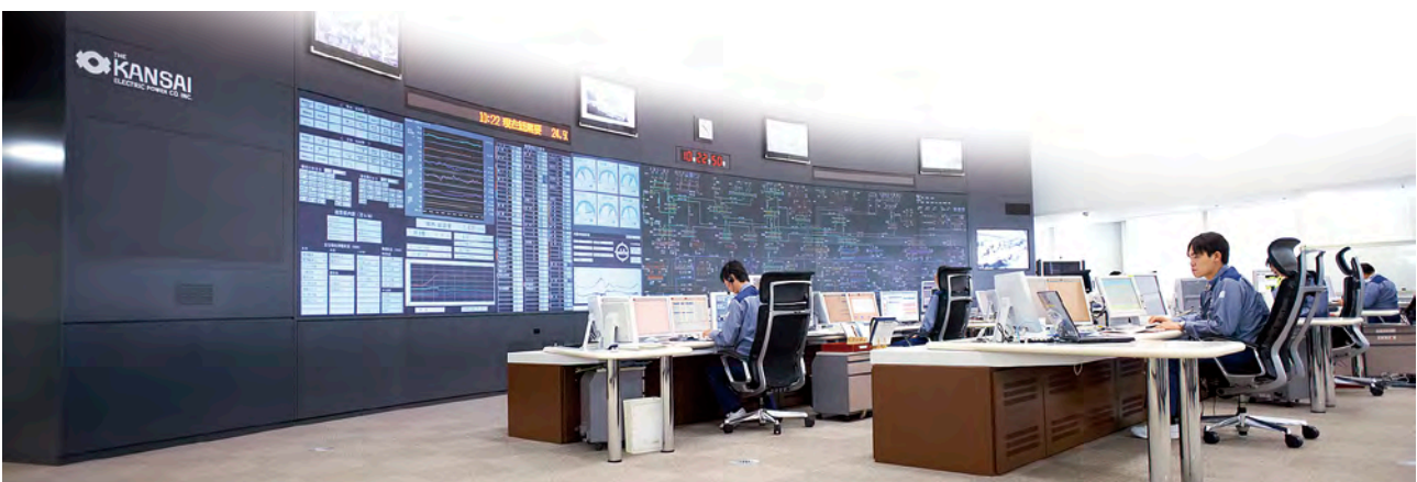
Central Load Dispatching Center (Kansai EPCo)
